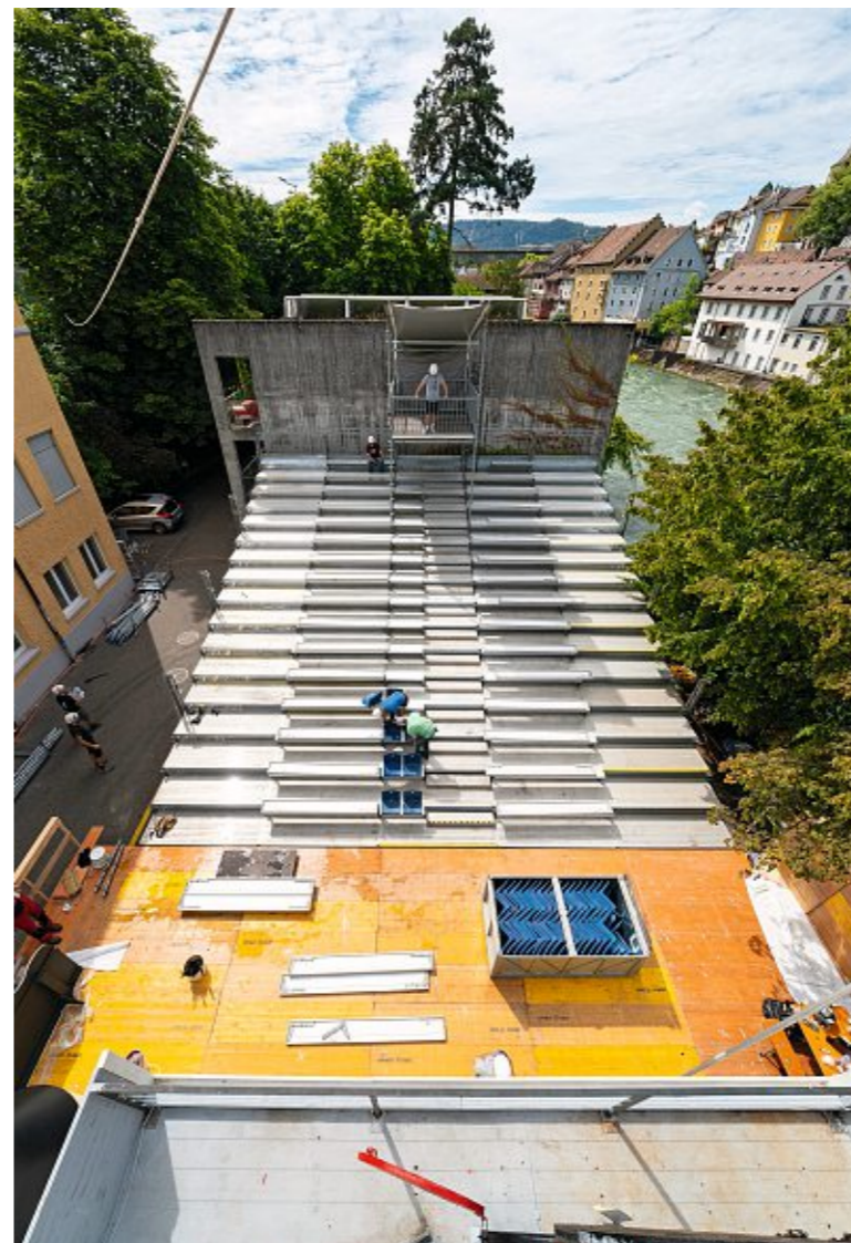
Stabil und durchdacht: Beim Aufbau des temporären Theaters muss jedes Detail stimmen.
